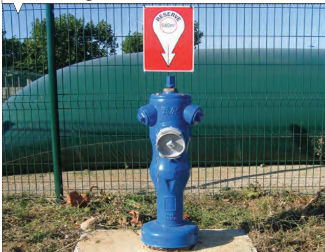
Panneau de signalisation à côté d'un P.E.I.
