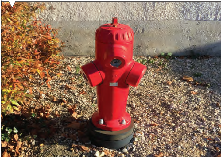
Poteau d'incendie « DN 150 » (raccords 2x100/1x65)
