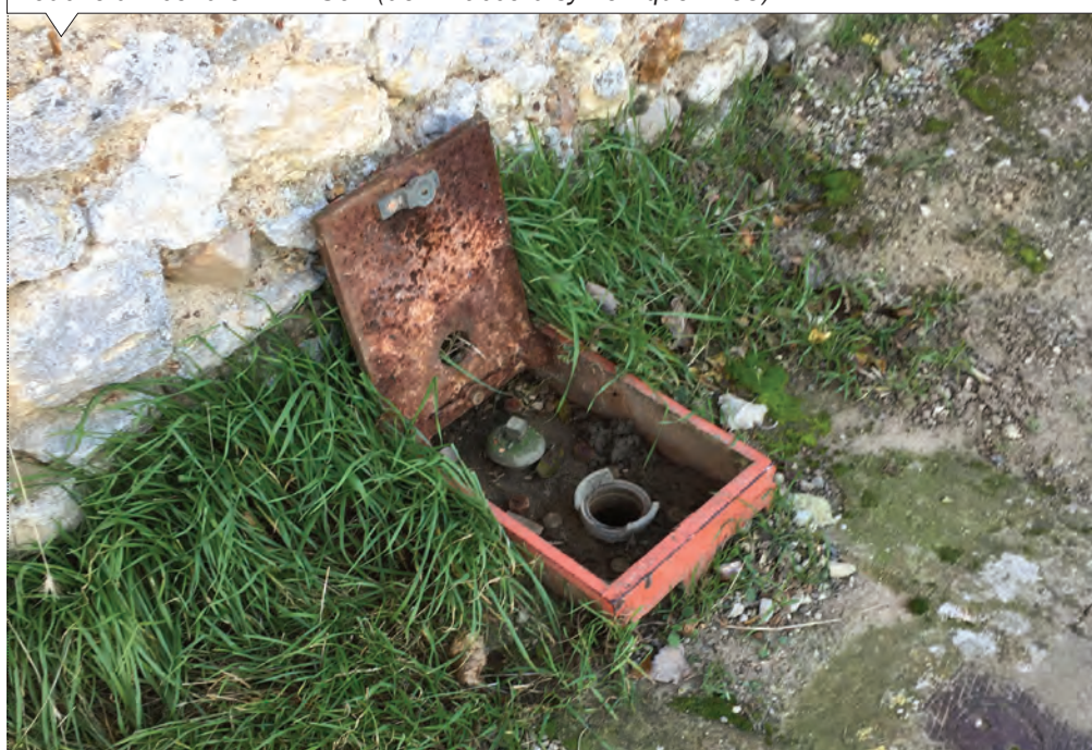
Bouche d'incendie « DN 80 » (demi-raccord symétrique 1x65)
