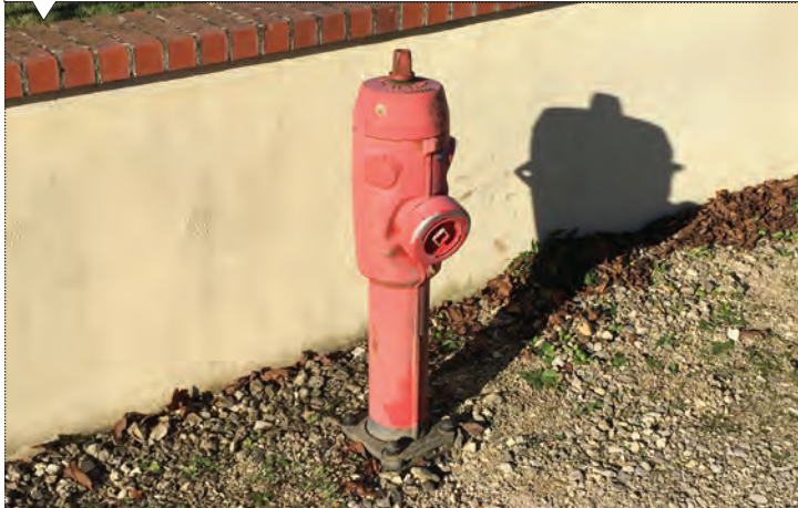
Poteau d'incendie « DN 80 » (raccord 1x65)
