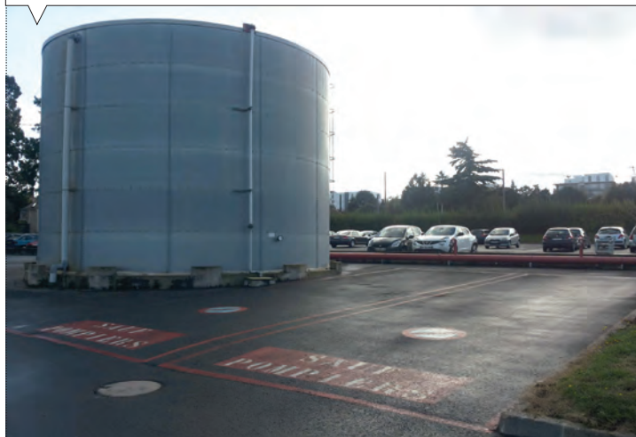
Plate-forme d'aspiration près d'une réserve aérienne
