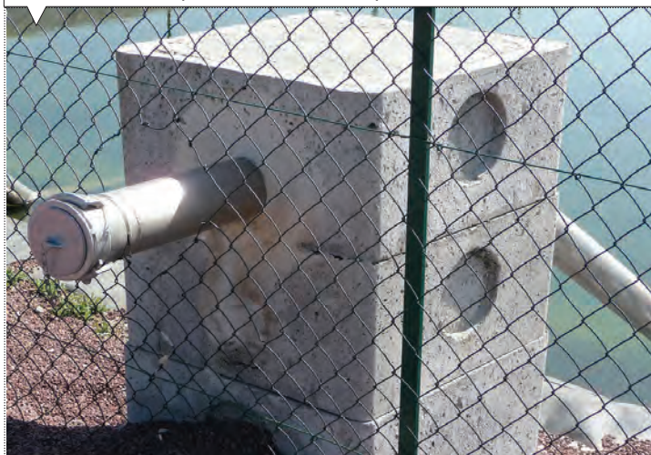
Colonne fixe d'aspiration alimentée par une réserve ouverte
