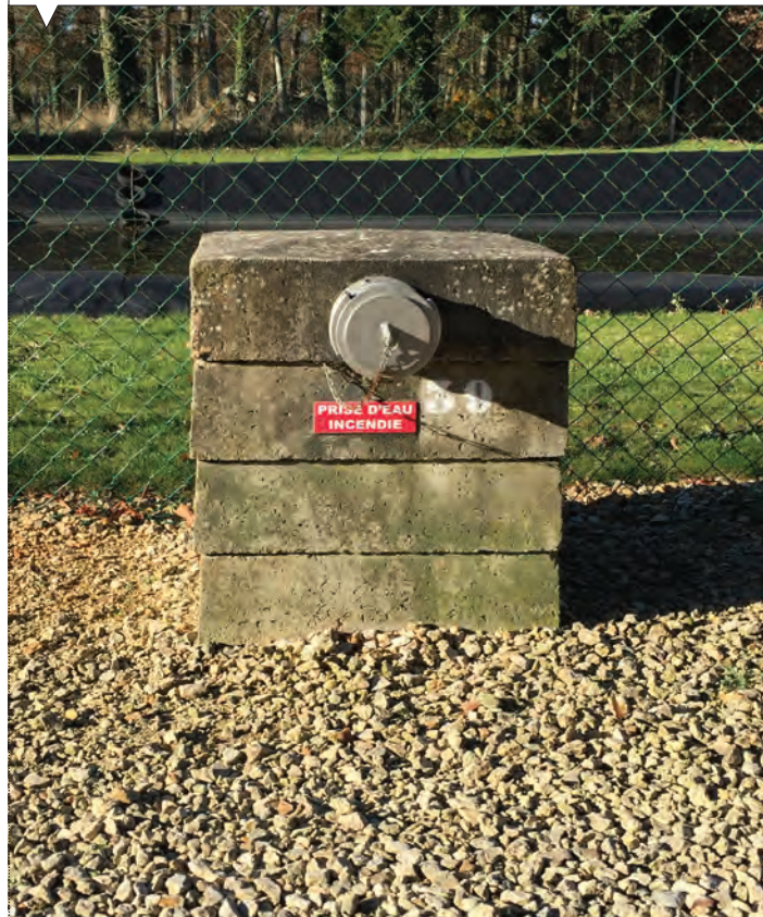
Point d'aspiration déporté sur une réserve ouverte
