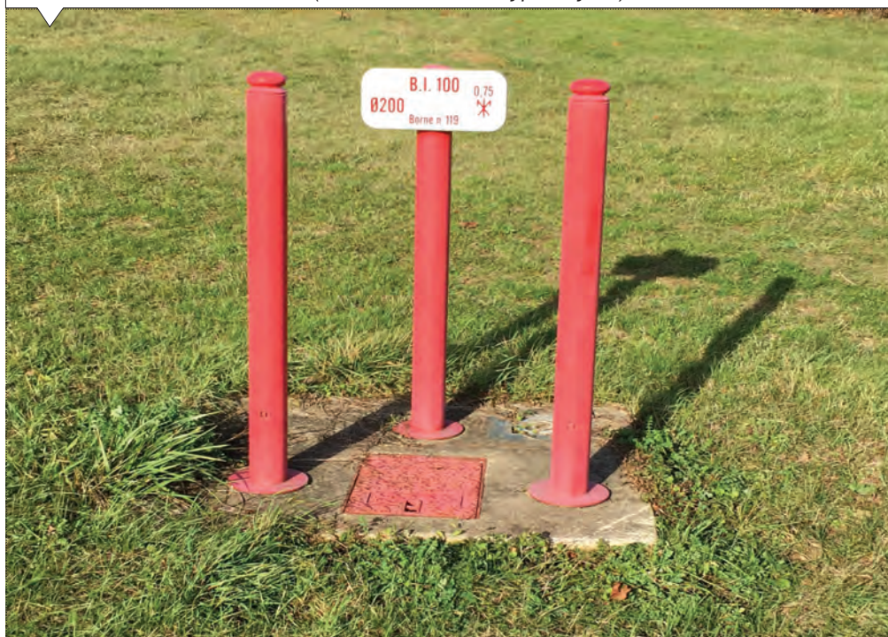
Bouche d'incendie « DN 100 » (raccord 1x100 de type Keyser)
